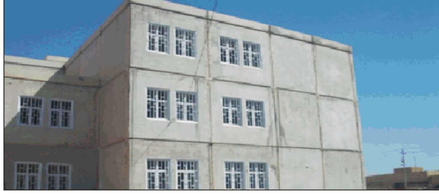
تركيب الجدران والسقوف للطابق الأرضي والأول، في حين تم إنجاز ٧٠% من أعمال تسطيح الجدران والسقوف بالمعجون والتيرامكس لمدارس (الصحابة وميسان وفتى الإسلام) بعد إنجاز صب السقوف للطابق الثاني والبيتونة. أما مدرسة الصفوة فهي بصدد نصب جدران السقوف الأولى بالقطع الخرسانية والتشطيب لمدارس (ميسان، إبراهيم الخليل وفتى الإسلام) والصحابة بعد إكمال هيكل البناءات الأربع، أما مدرستي (المناهل وهاني بن عروة) فالعمل مستمر بتهنية تنفيذ أعمال الكاشي بعد إنجاز أعمال
